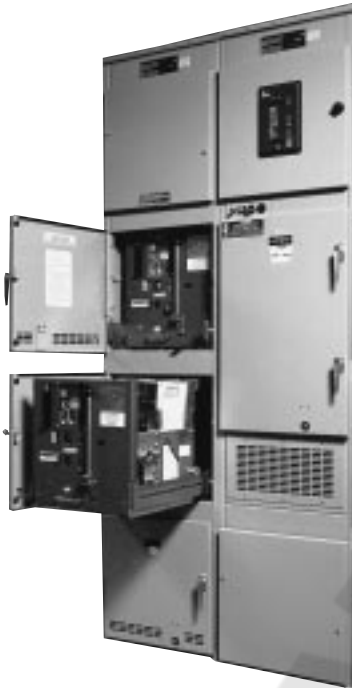
DS Switchgear Assembly
