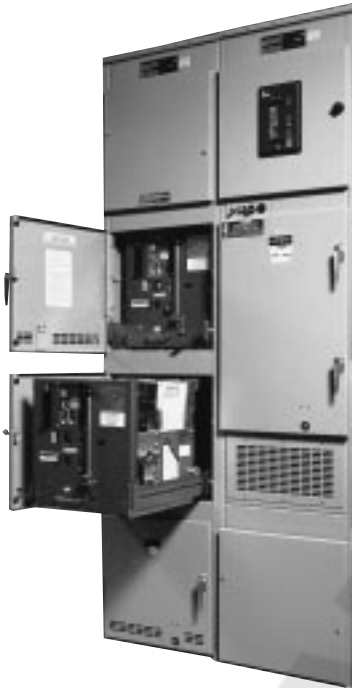
DS Switchgear Assembly
